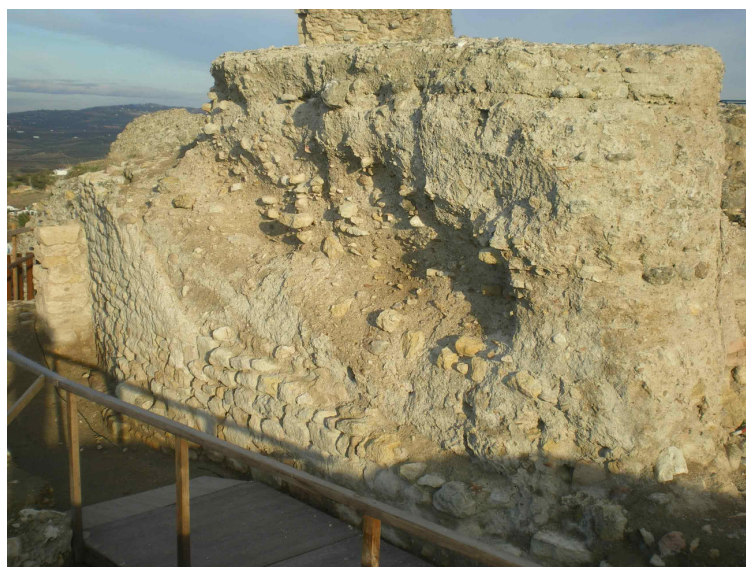
Figura 5. Ejemplo del estado de conservación del tapial.
